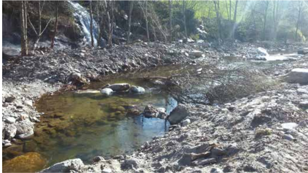
Neu geschaffenes Seitengewässer entlang der Passer oberhalb Gomion. Zur Strukturaufwertung und als Schutz vor fischfressenden Vögeln wurden vereinzelt Baumkronen eingebracht.
