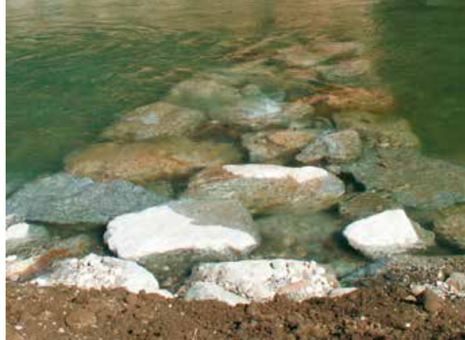
Massive Zyklopenbuhnen am linken Ufer
