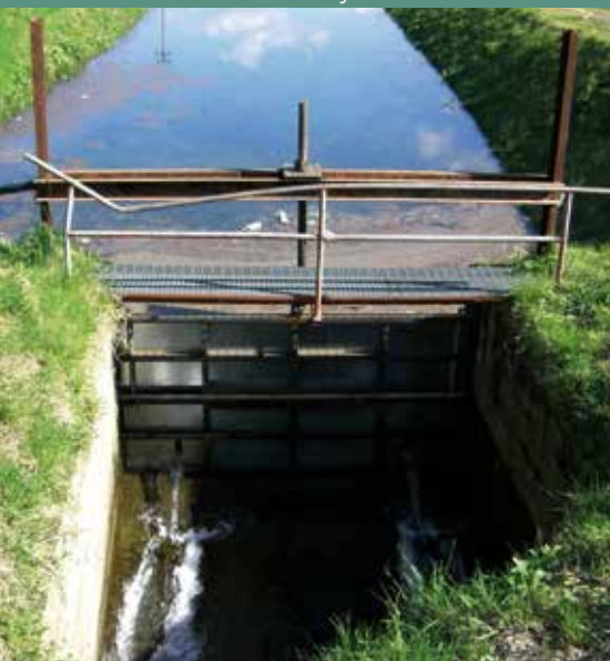
Schleusenanlage für Beregnungszwecke – auch diese Anlagen stellen zumindest zeitweilig ein Wanderhindernis für Fische dar.
