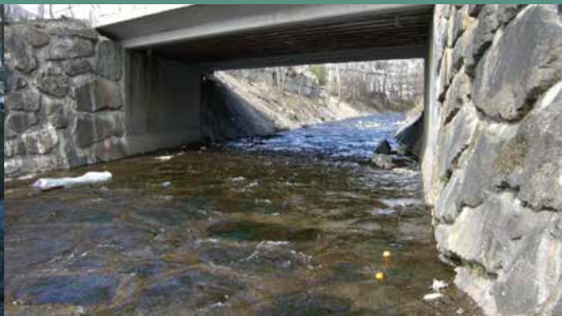
Sohlverbauung bei Brücke – auch im Umfeld von Eisenbahntrassen und Straßen bestehen Bauwerke, welche die Fischpassierbarkeit beeinträchtigen.
